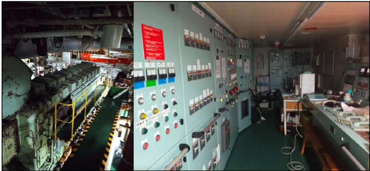
圖 6 機艙緊急照明
